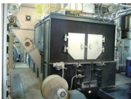
バイオマスボイラー1号機
