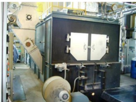
バイオマスボイラー1号機
