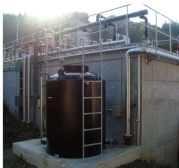
排水処理施設
