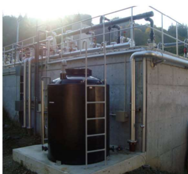
排水処理施設
