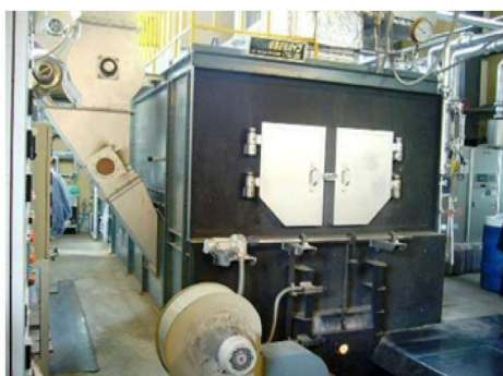
バイオマスボイラー1号機
